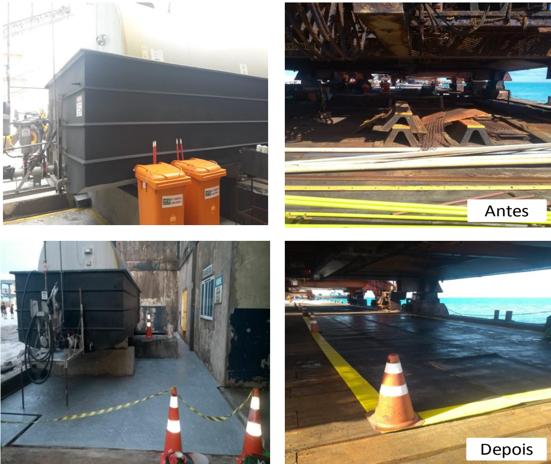
Figura 6. Instalação do Sistema de Contenção para abastecimento no TERSAB.
